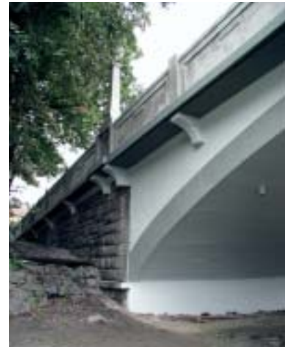
Obr. 6 Most po opravě – detail pohledu Fig. 6 Bridge after the overhaul – detail of the soffit
