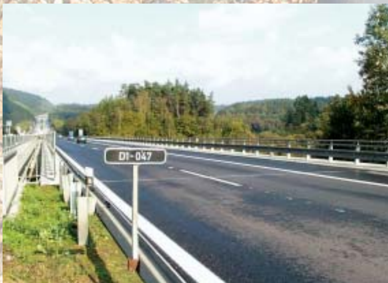
Rekonstrukce mostu D1-047 přes Blanici, obnovení provozu po hotové mostovce Reconstruction of D1-047 bridge across the Blanice River, renewal of the operation on the completed bridge deck
