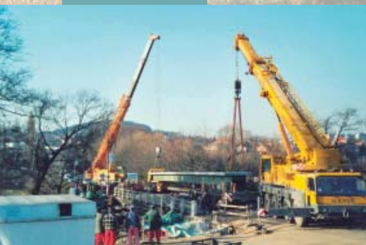
Výstavba lávky u silnice I/18 v Sedlčanech Construction of a footbridge near I/18 road in Sedlčany
