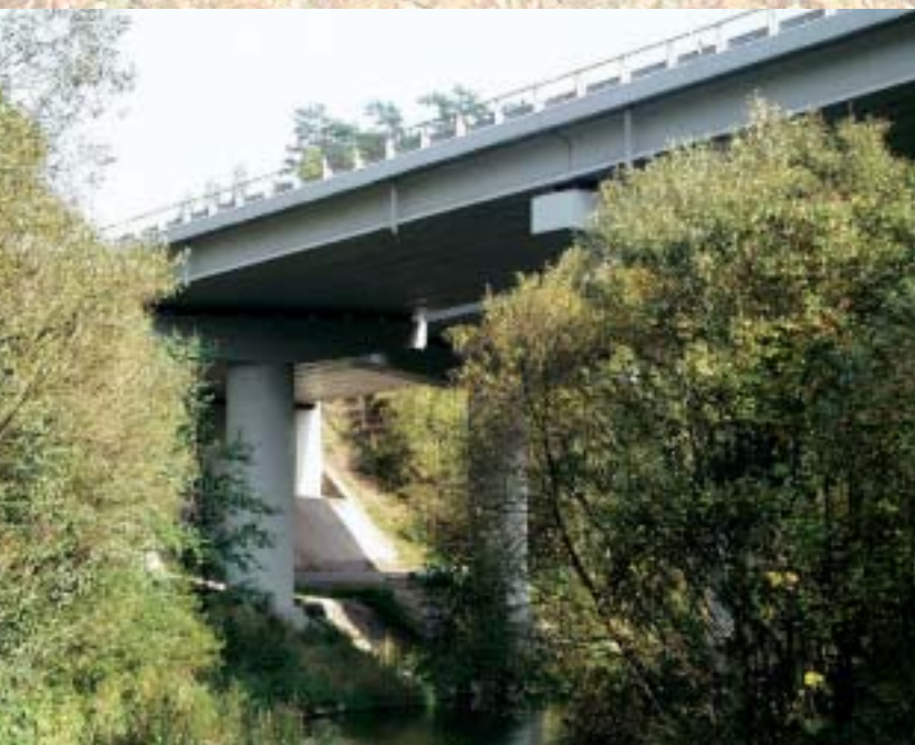
Rekonstrukce mostu D1-047 přes Blanici Reconstruction of D1-047 bridge across the Blanice River
