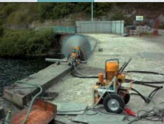
Řezání stěnovou pílou – VD Orlík Cutting with the wall saw – Orlík hydraulic structure
