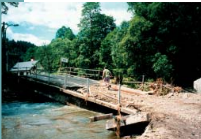
Obr. 3 Zřícený most přes řeku Moravu u obce Vlaské Fig. 3 Collapsed bridge over the Morava River close to Vlaské village
