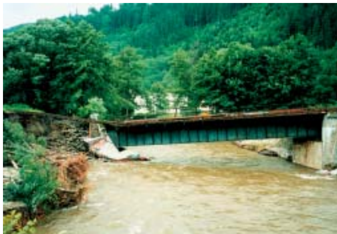
Obr. 1 Těžce poškozený železniční most přes Moravu u Hanušovic Fig. 1 Heavily damaged railway bridge over the Morava River near Hanušovice
