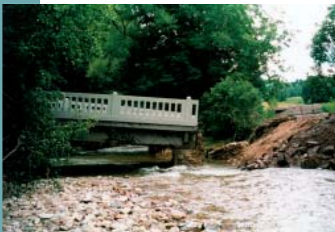
Obr. 5 Zřícený most přes řeku Moravu u obce Zlatý Potok Fig. 5 Collapsed bridge over the Morava River near Zlatý Potok village
