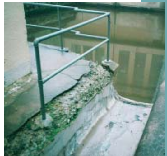
Obr. 5 Poškození betonů kolem budovy spodních výpustí Fig. 5 Damaged concrete round the building of the bottom outlets
