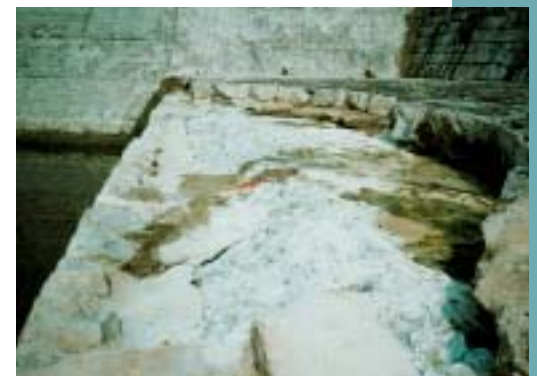
Obr. 6 Poškození prvního stupně kaskády Fig. 6 Damaged first cascade weir
