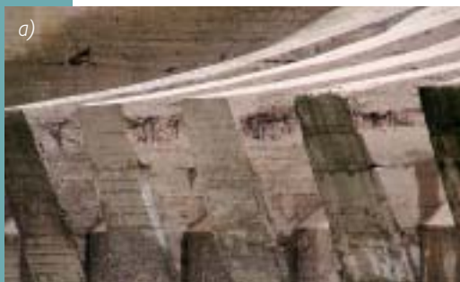
Obr. 6 Porušení rozražečů na konci přelivné plochy po povodni; a) celkový pohled, b) detail
