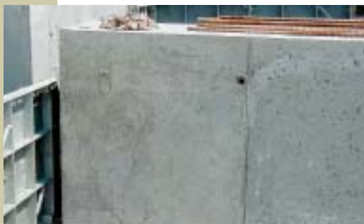
Obr. 2 Povrch betonu v nejvzdálenějším místě konstrukce od místa ukládní Fig. 2 Concrete surface in the place of the structure farthest from the placing site
