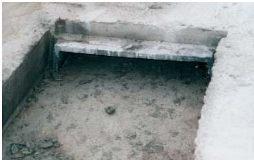
Obr. 8 Instalační otvor v místě jádra Fig. 8 Installation opening in the place of service core
