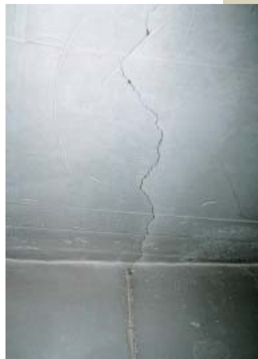
Obr. 5 Radiální trhliny na spodním líci desky dna Fig. 5 Radial cracks in the bottom face of the base
