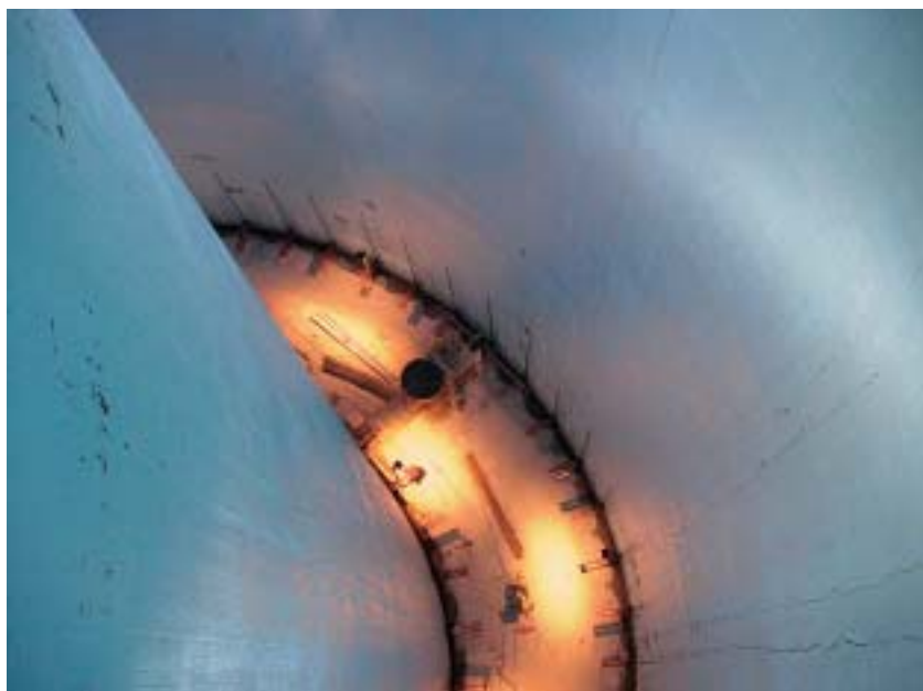
Obr. 4 Pohled do vnější komory sila: viditelné trhliny ve vnějším pláští Fig. 4 View of the external chambers of the silo: visible cracks in the external jacket
