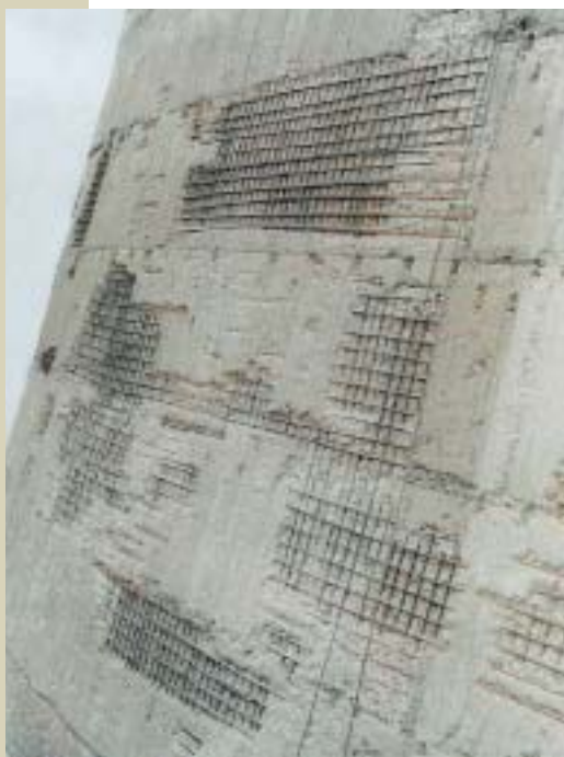
Obr. 2 Charakter poruch pláště věže Fig. 2 Character of fractures of the jacket of the tower
