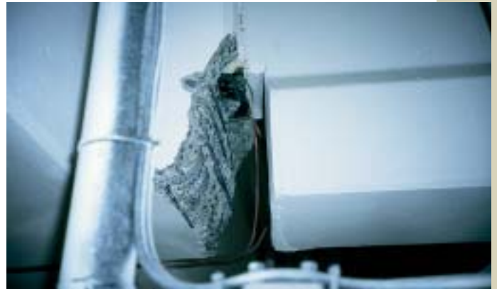
Obr. 8 Pohled na odpadlý beton části konzoly průvlak, na které spočívá uložení krokve rozpětí 24 m
