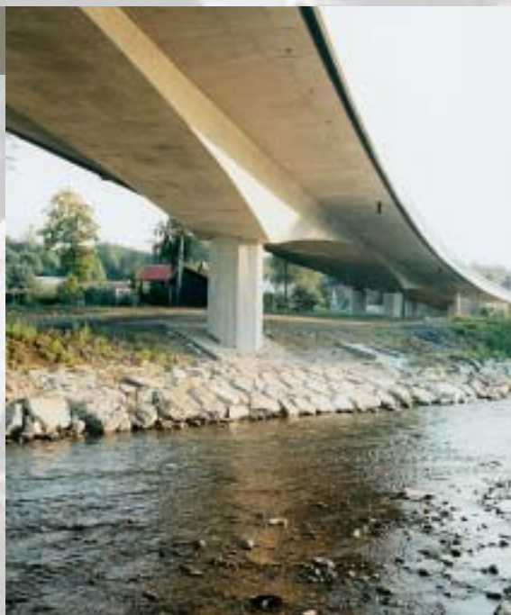
Most přes řeku Bělou na silnici I/44 Bridge over the river Bělá in road I/44
