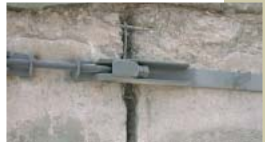
Obr. 7 Detail stažení s hlubokým vysekaním smršťovací spáry
