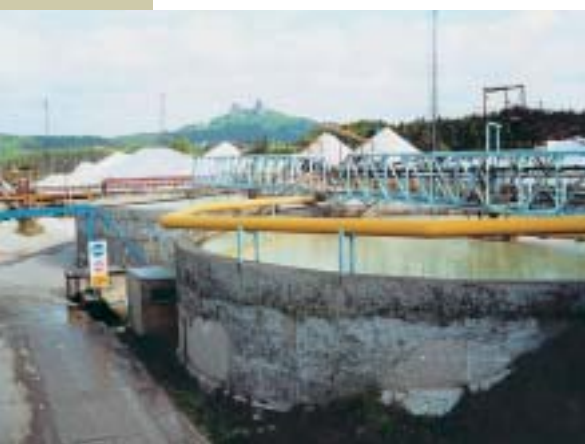
Obr. 1 Pohled na nádrže Fig.1 View of the basins
