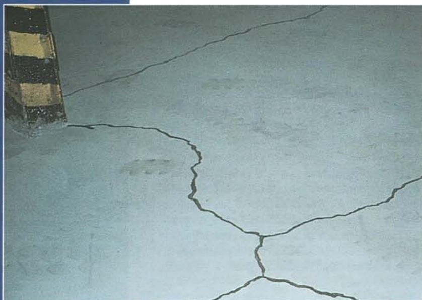
(K Příkladu 4) Obr. 3 Nedostatečně vyztužená betonová podlaha v průmyslové hale
