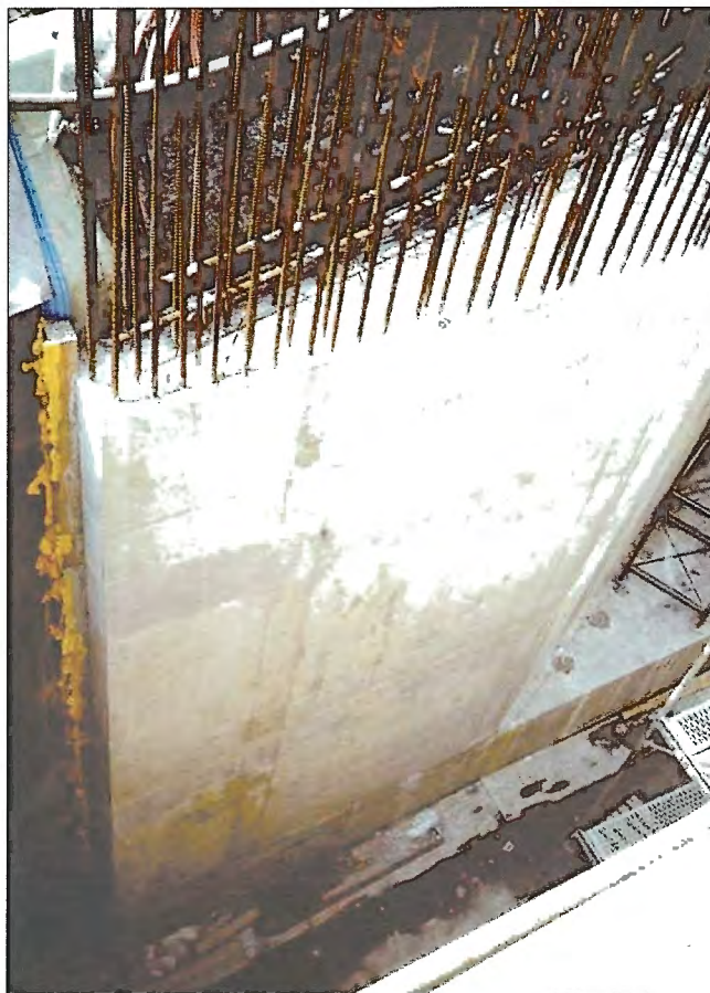
Obr. 4 – Povrch a kolmá hrana betonové stěny / Surface and edge of the concrete wall
