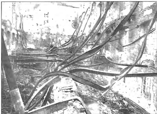
Obr. 1 – Železná konstrukce po požáru / Steel structure after a fire
