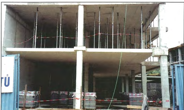
Obr. 14 – Objekt JV - deska míjející sloupy / Building JV - ceiling slab passing by the columns
