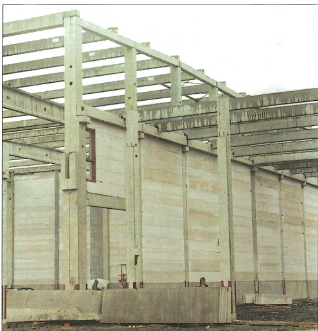
Obr. 6 – Krajní pole haly - střešní trámy ve dvou výškových úrovních s osazenými vaznicemi / Abutment span of the hall - roof beams in two height levels with embedded purlins
