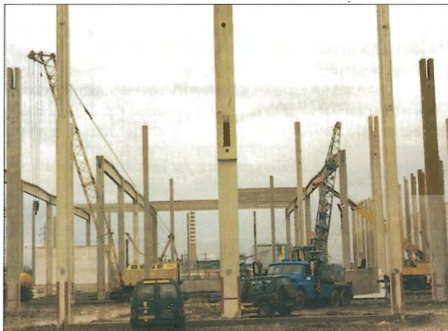
Obr. 3 – Sloupky s vidlicemi ve dvou výškových úrovních pro osazení vazníků / Columns with forks in two height levels for the seating of joining balks
