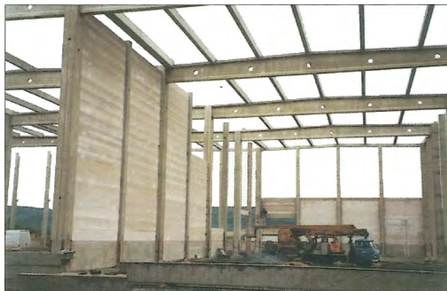
Obr. 10 – Pohled na část smontované nosné konstrukce haly / View of a part of the assembled bearing structure of the hall
