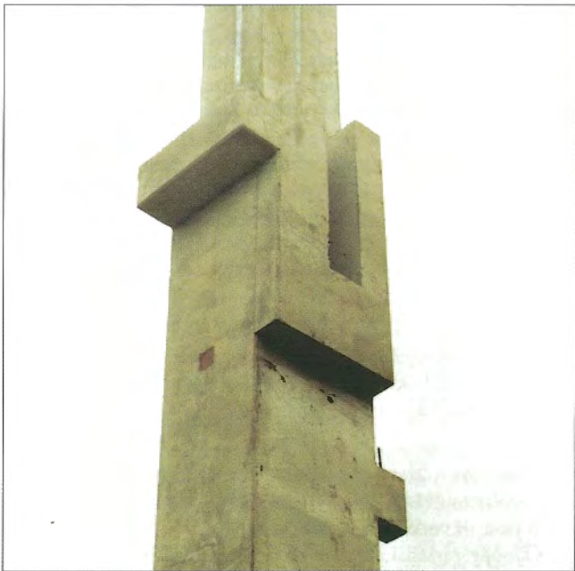
Obr. 4 – Rohový sloup s detailem vidlice pro osazení nižšího vazníku, konzoly pro střešní trám a konzoly pro nadpraží požární stěny / Corner column with a detail of the fork for the seating of the lower joining balk, brackets for the roof beam, and brackets for the firewall cap
