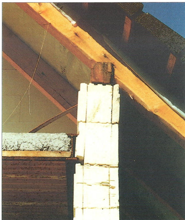
Obr. 2 – J. Knež: Dobře čitelné rozpěrné účinky dřevěného krovu a dodatečně přidané táhlo. / Thrust effects produced by a timber roof structure
