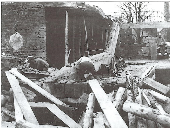
Obr. 7 – T. Vaněk: Odklizení trosky po havárii střechy. Příčinou byl nekvalitní beton – měl pevnost tvrdého chleba / Removal of debris after a roof collapse; the concrete strength was like hard bread strength
