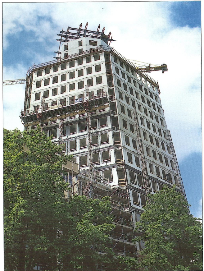
Obr. 17 – Hybridní konstrukce při výstavbě v Haagu / A hybrid skeleton under construction in The Hague
