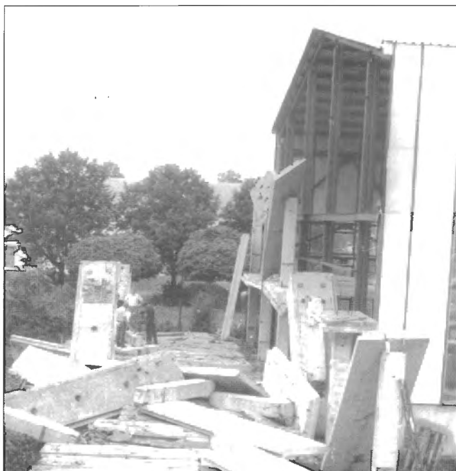
Obr. 1 – T. Vaněk: Havárie části montovaného skeletu MS 71. V průběhu montáže nebyla zajištěna stabilita, přičemž soustava je velice citlivá na nesouměrné zatížení. Objekt byl rozbourán a postaven znovu, převážně z nových prvků / Collapse of an assembled system caused by asymmetrical loading
