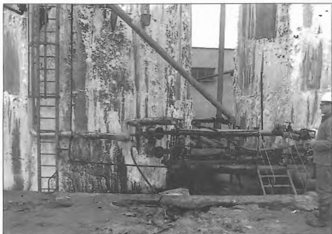
Obr. 8 – T. Vaněk: Poněkud méně „kvalitní“ pracovní spáry sodojemu. Soda proniká na vnější líc, kde krystalizuje. Sanovalo se to vnitřním plechovým opláštěním / Working joints in a caustic soda tank; internal steel sheathing was used
