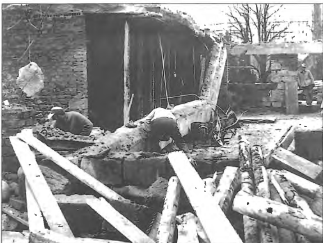
Obr. 7 – T. Vaněk: Odklizení trosků po havárii střechy. Příčinou byl nekvalitní beton – měl pevnost tvrdého chleba / Removal of debris after a roof collapse; the concrete strength was like hard bread strength
