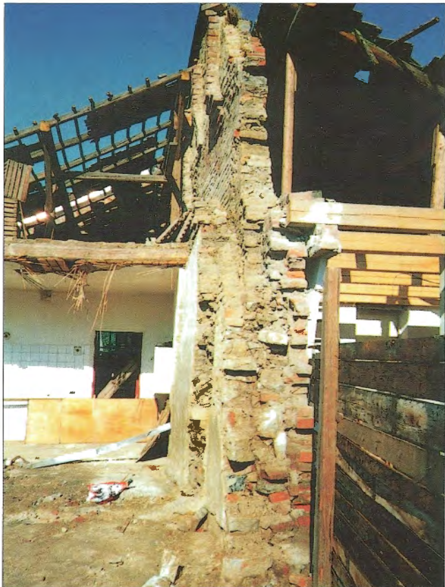
Obr. 3 – J. Vrba: Dilatační spára mezi dvěma objekty řadové zástavby v okrajové části Olomouce. Jde o místo zasažené povodní v roce 1997. Majitel parcely vlevo trvá na zbourání celé zdi jeho objektu a majitel vpravo naopak chce nemovitost opravit. Celé je to nesmysl, neboť i na fotografiích je patrné, že pod zdí není izolace proti zemní vlhkosti. Sotva se najde někdo, kdo dokáže zeď objektu vlevo bezkonfliktně odbourat / A nonexistent expansion joint between two buildings damaged by floods in 1997. One of the owners intends to dismantle „his“ wall.
