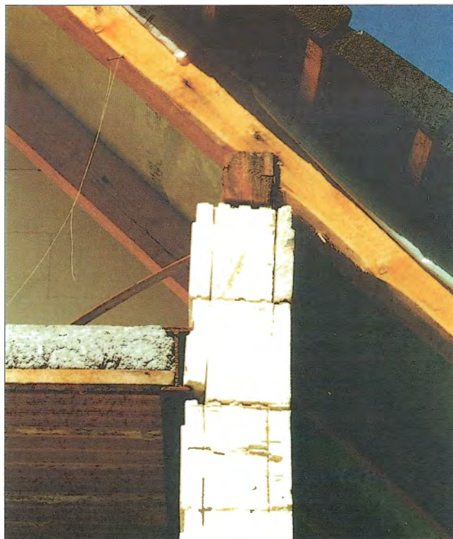
Obr. 2 – J. Kneř: Dobře čitelné rozpěrné účinky dřevěného krovu a dodatečně přidané táhlo. / Thrust effects produced by a timber roof structure
