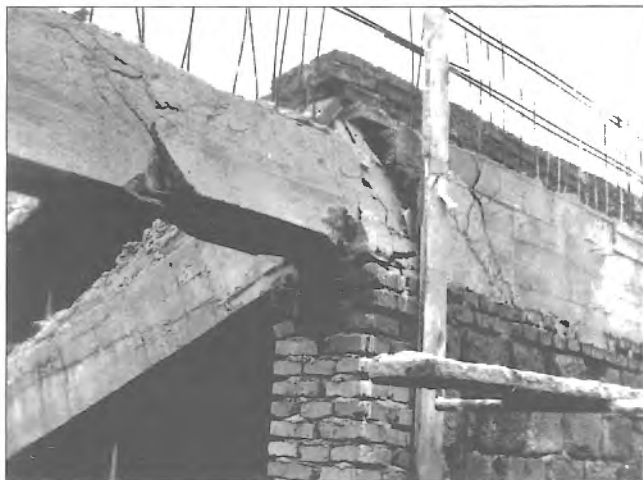
Obr. 4 – T. Vaněk: Neobvyklé pootočení styčnicku v místě uložení / A rather unusual rotation of a frame joint
