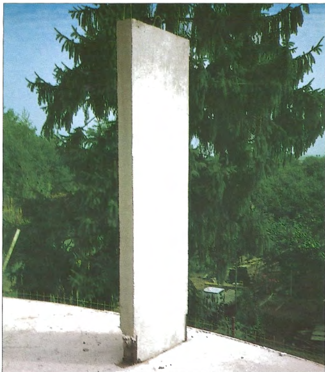
Obr. 4 – Detail volné krátké stěny na stropní konstrukci / Detail of short precast wall on the floor slab
