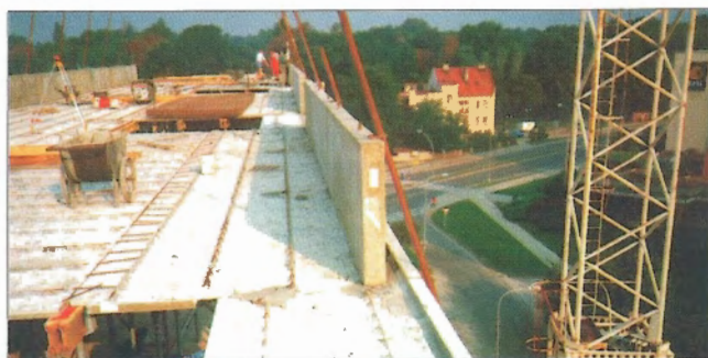
Obr. 9 – Montáž filigránového stropu a betonových parapetů / Assembly of "filigran" floor slab and RC parapet panels
