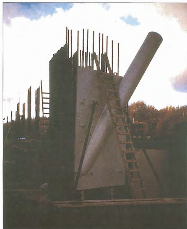
Obr. 6 – Styk ocelového ztužidla s rohovým sloupem / Connection of steel bracing with corner column
