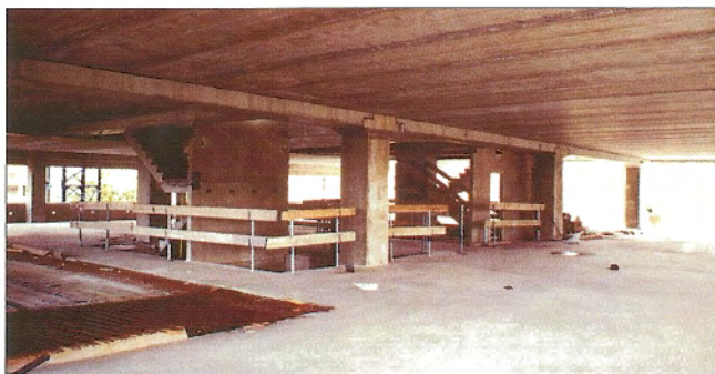
Obr. 11 – Vnitřní volný prostor podlaží - jádro využito pouze pro vertikální komunikace / Free inside space of floor - The core is used for vertical transport only
