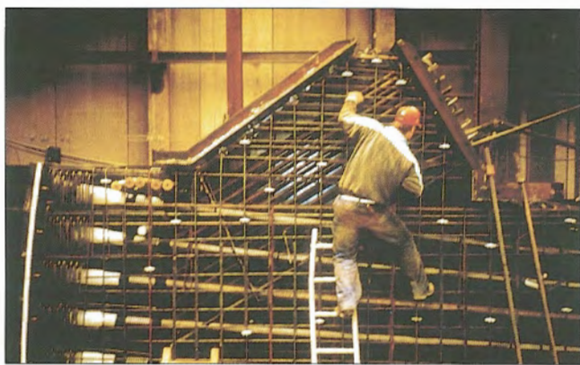
Obr. 5 – Detail styku ocelového ztužidla s monolitickým rohovým sloupem / Detail of connection steel bracing to the cast in situ corner column
