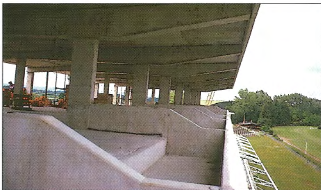
Obr. 15 – Pohled na konzolovou část stropní konstrukce / The view on console part of stand
