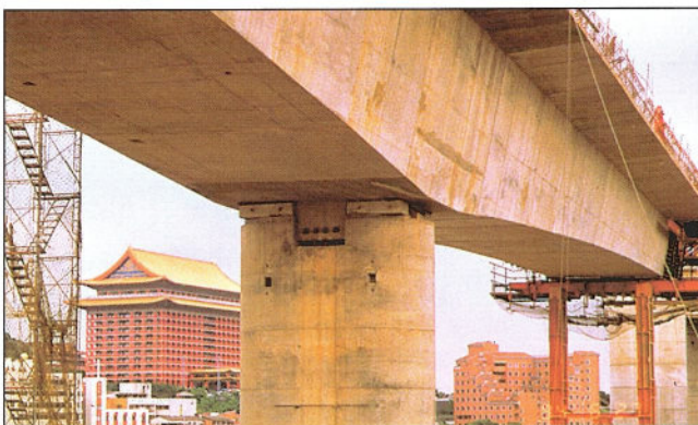
Obr. 8 – Vnitřní podpěra krajních polí – podepření konstrukce hrncovými ložisky, smykový ozub / Intermediate pier of the side spans – supporting of the deck by pot bearings, shear key
