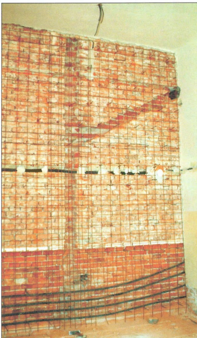
Obr. 8 – Úprava kabelových vedení u vnitřní nosné zdi / Prestressing cable situation in internal loadbearing wall
