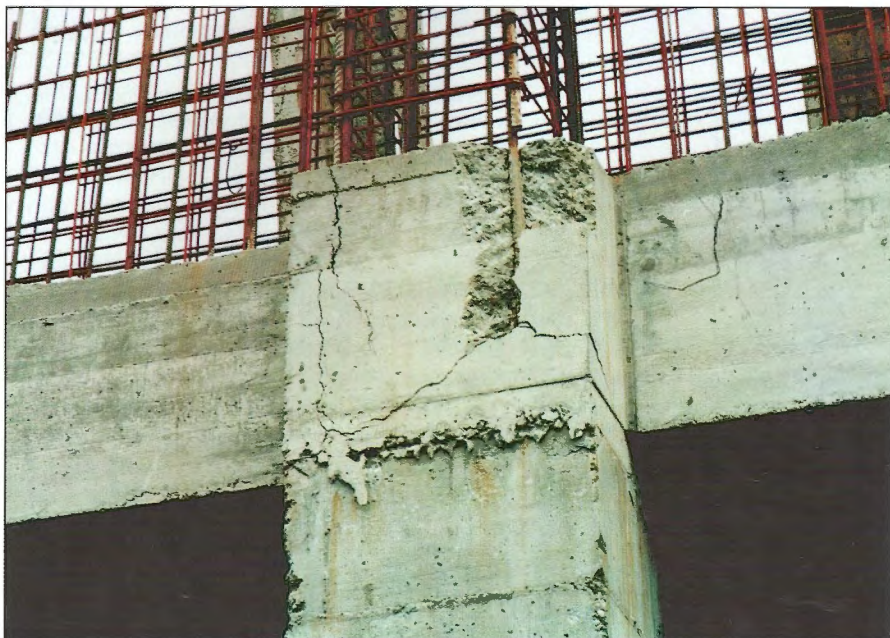
Obr. 3 – Poruchy sloupu v oblasti napojení desky k přilehlé obdélníkové budově vyvolané nadměrnou deformací desky / Failure of column head in the joint of the slab and the rectangular part of building
