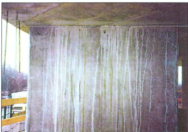
Obr. 2 – Šikmé trhliny ve sloupové stěně od smršťování betonu velmi tlusté stropní desky / Inclined cracks in concrete wall caused by shrinkage of a very thick flat slab
