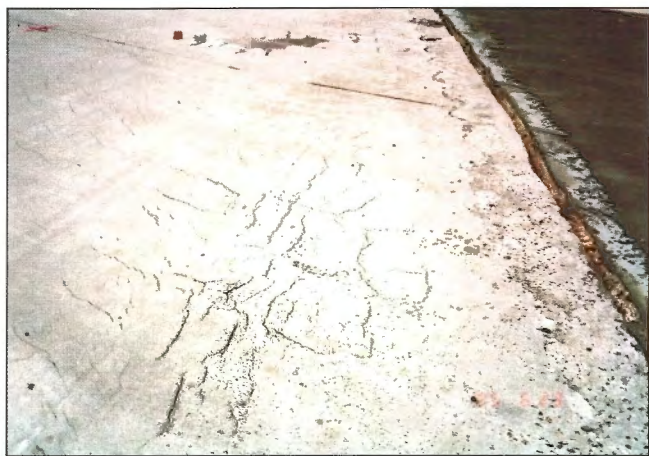
Obr. 1 – Povrchové trhliny od plastického smršťování a od sedání / Surface cracks caused by plastic shrinkage and by the settlement
