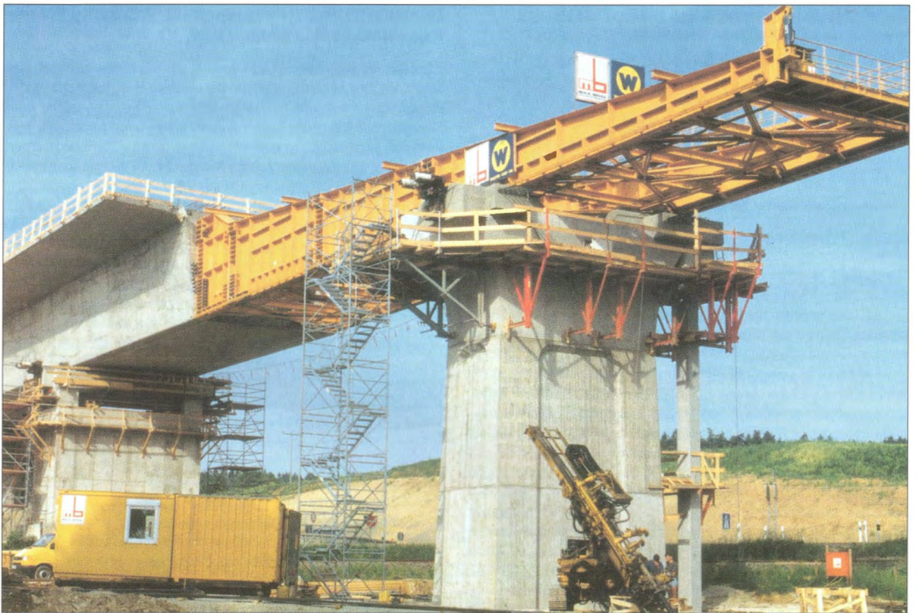
Obr. 1 – Novostavba údolního mostu Schnaittach metodou vysouvání nosné konstrukce ze segmentových dílců s předsunutým ocelovým nosem – viz referáty sekce 1 (přetištěno s laskavým svolením fy WALTER-BAU-AG, D-83153 Augsburg)
