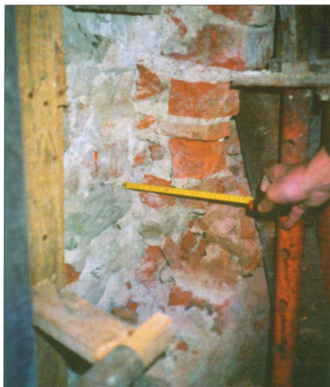
Obr. 4 – Detail dodatečné cihelné obezdívky kamenného pilíře v přízemí / Detail of the additional brick lining of the stone pillar situated on the ground floor
