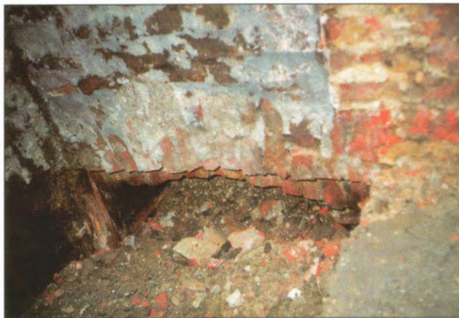
Obr. 5 – Detail náhodně odkrytého druhého suterénu / Detail of the second basement uncovered by chance
