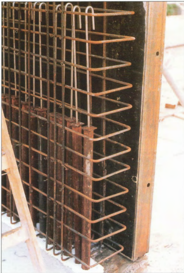
Obr. 3 – Kyvná táhla před betonáží stěnového nosníku / Ties before concreting of the deep beam
