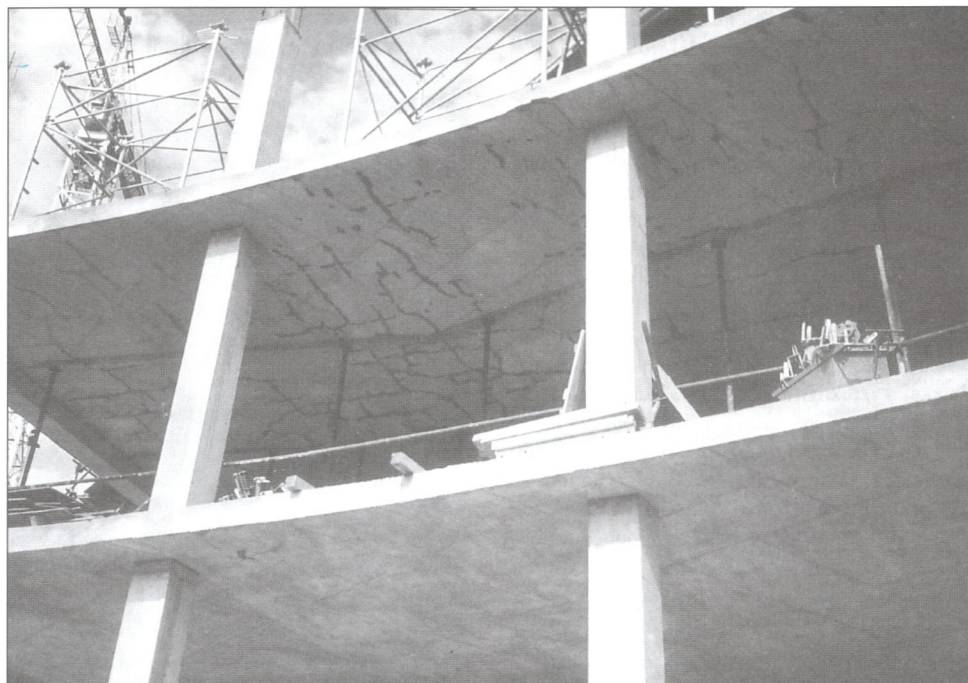
Obr. 8 – Smršťovací trhliny ve stropní desce, zvýrazněné průsaky srážkové vody / Shrinkage cracks in the floor slab, shown by leaks of rain water
