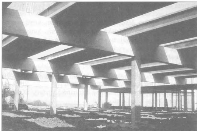
Obr. 6 – Skelet Premo při výstavbě obchodního střediska NICO v Říčanech u Prahy / System PREMO under construction of the department store Nico near Prague
