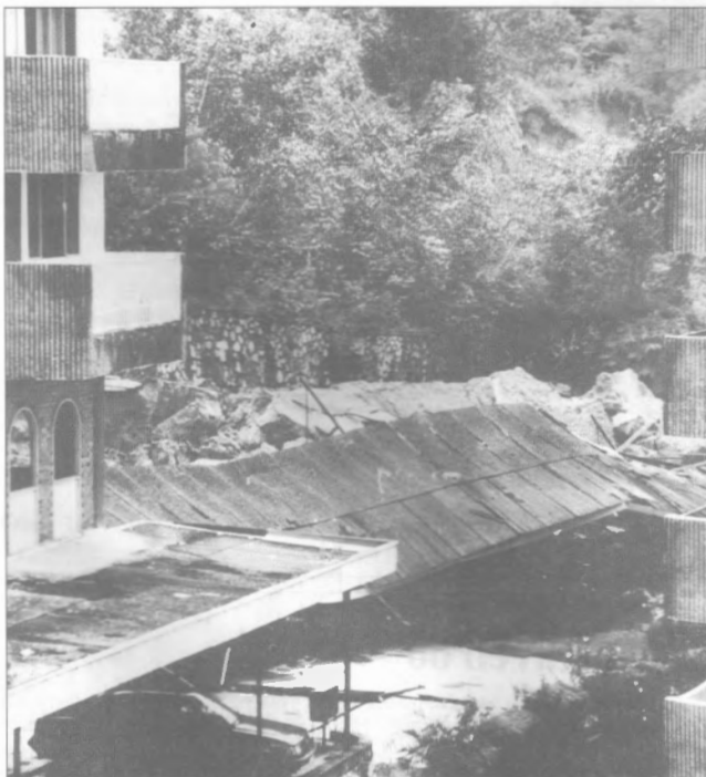
Obr. 2 – Pohled na porušenou střechu garáže a nadzvednutou zemi- nu. Vpravo balkony domu, který se za okamžik zřítí
