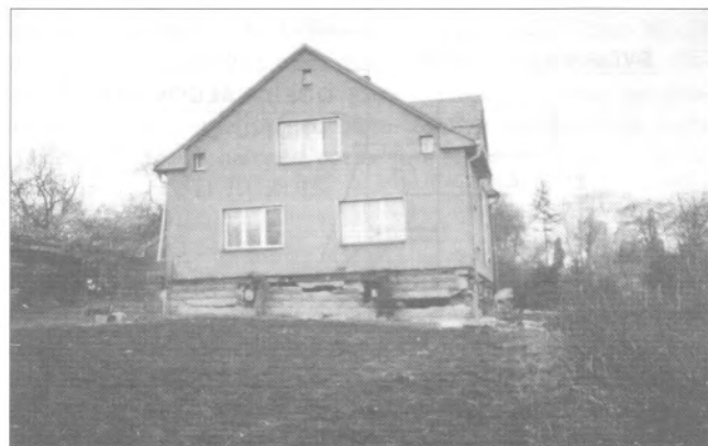
Obr. 8 – Rodinný dům v Orlové po rektifikaci před vyzdáním spáry
