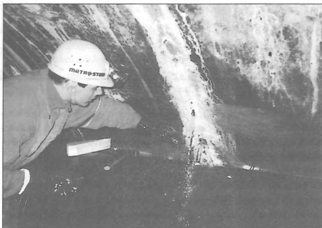
Obr. 4 – Výron vody spárou konstrukce
