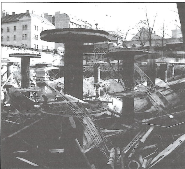
Obr. 2 – A takto to dopadlo 26. října 1979. Fotografie ze staveniště budovy Obchodního a administrativního centra v Praze 7 do poledne po zřícení dvou stropních desek o celkovém objemu 1500 m 3 betonu
