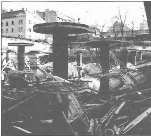
Obr. 2 – A takto to dopadlo 26. října 1979. Fotografie ze staveniště budovy Obchodního a administrativního centra v Praze 7 dopoledne po zřícení dvou stropních desek o celkovém objemu 1500 m 3 betonu
