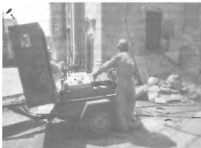
Obr. 5 - Sanace vlhkého zdiva na kostele Sv. Jana v Nepomuku - Ustavení lanové pily
